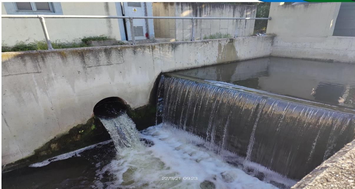
Εικόνα 4. Δεξαμενή εξόδου του νερού του βιολογικού σταθμού
